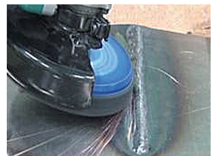
Rmover decoloración de la soldadura
